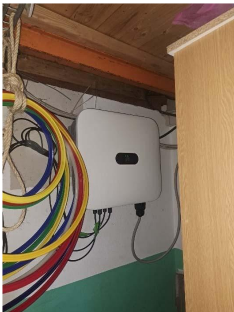
Der installierte Wechselrichter (links) sowie Stromspeicher (rechts)
